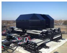
写真-2 AMDの外観
